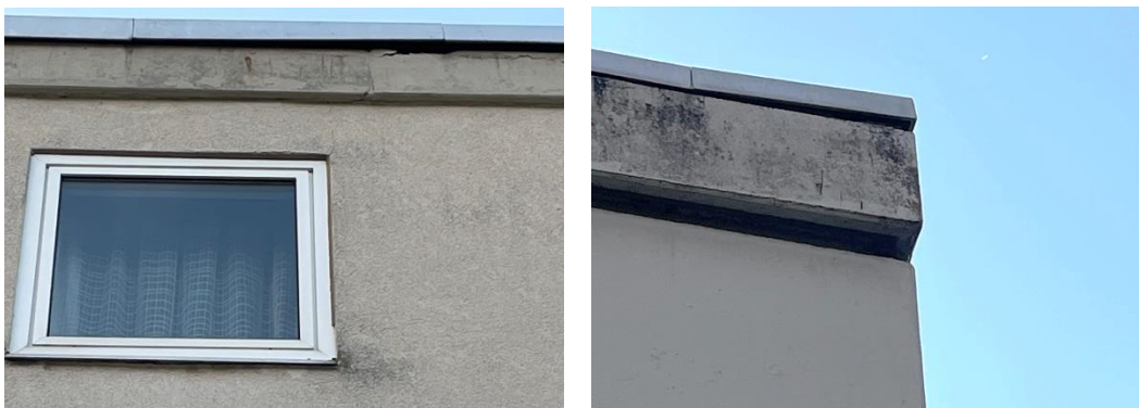
Abb. 6: Beispiele für Hohlräume unter Dachabdeckung: Südseite Gebäude Nr. 109 (rechts) und Südostseite Gebäude Nr. 109 (links)
