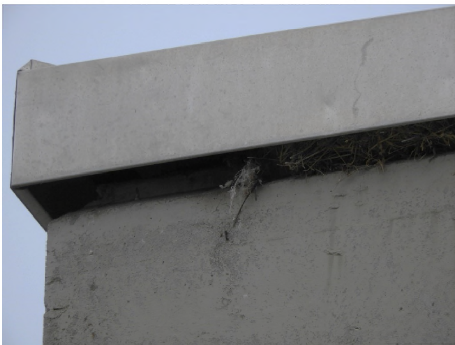
Abb. 3: Nest eines Gebäudebrüters im Untersuchungsgebiet
