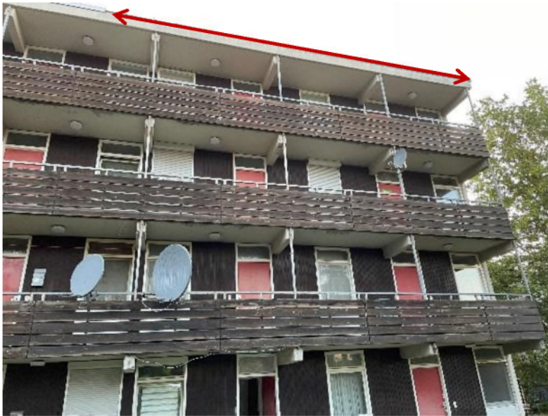
Abb. 5: Entferntes Attikablech an Gebäude 109
