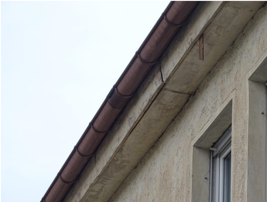
Abb. 3: Nur vereinzelt sind die hölzernen Traufkästen an den Gebäuden durch schmale Spalten zugänglich.
