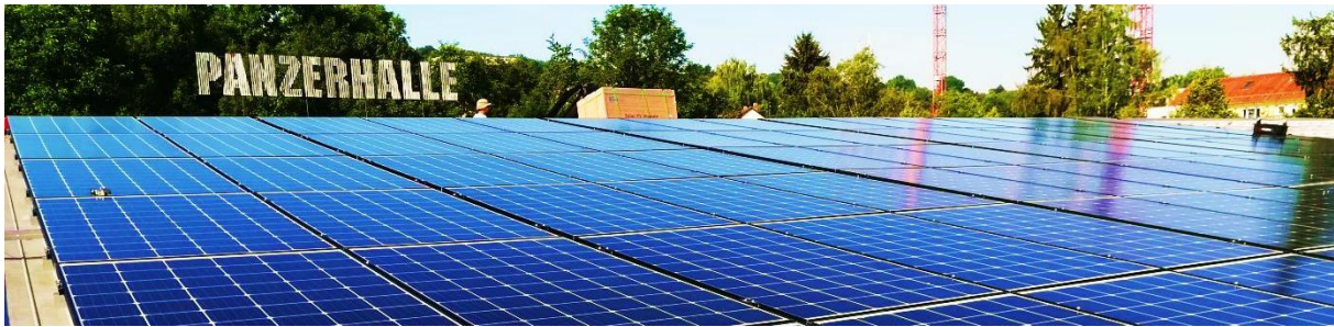
Abbildung 4 PV-Anlage der SWT auf der städtischen Ballspielhalle
