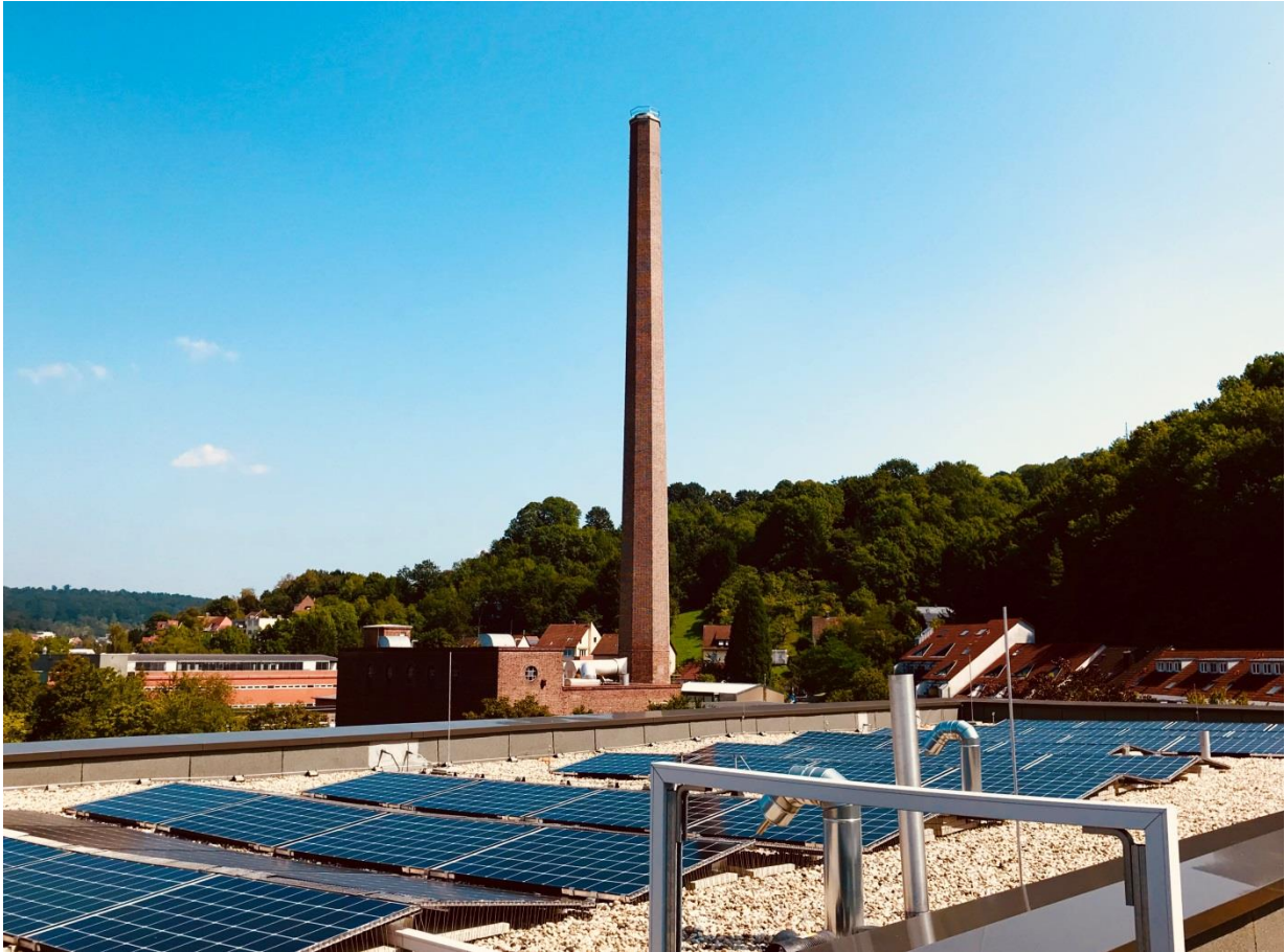
Abbildung 3 PV-Anlage Technisches Rathaus Tübingen
