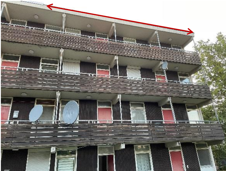
Abb. 5: Entferntes Attikablech an Gebäude 109
